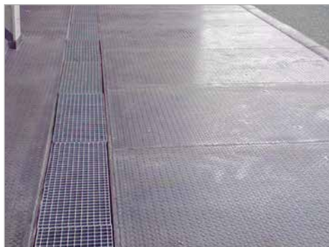
Ablaufrinne mit Gitterrost
