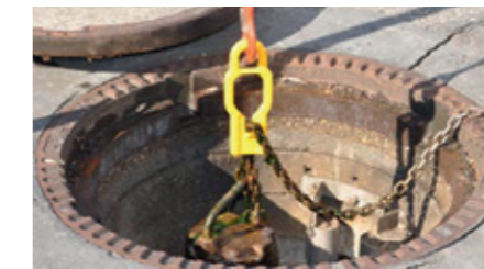
Heben von Pumpen mittels Pumpengreifstück
