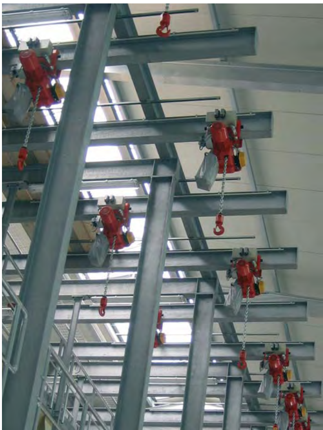
Mehr als 30 HADEF Elektro-Kettenzüge Figur 66/04 AKE mit Positionsschalter zum Einfüllen von Baustoffen in große Industriemischer
