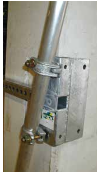
Typ (C) + (D) Dachrandsicherung
