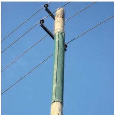
Spechtschutz am Holzmast
